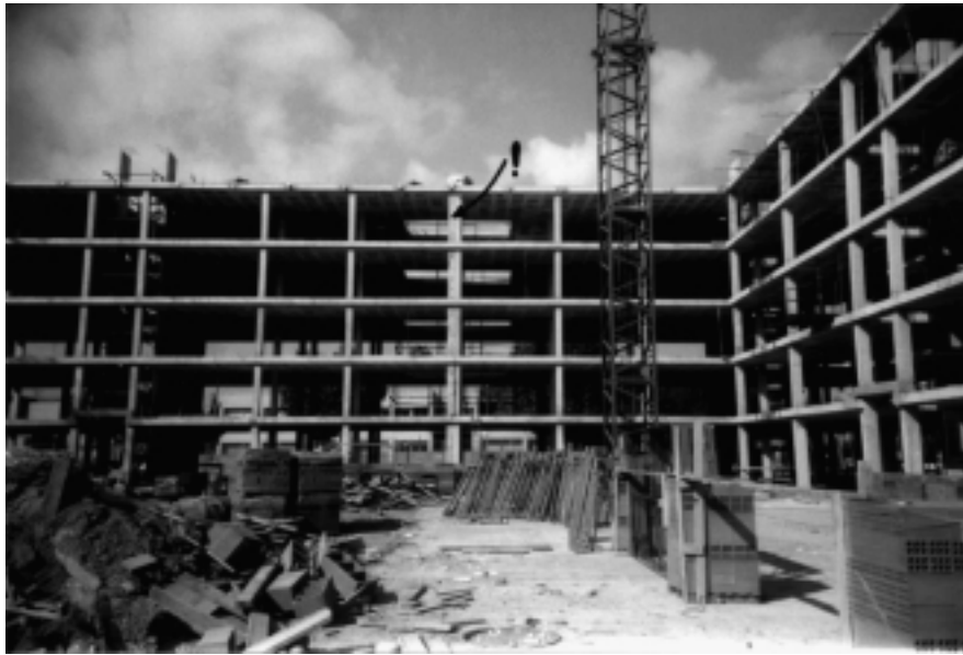
Foto 6.2 Edificio con columnnas y forjados reticulares. Puede verse que la junta entre los módulos del edificio no son antisísmicas
