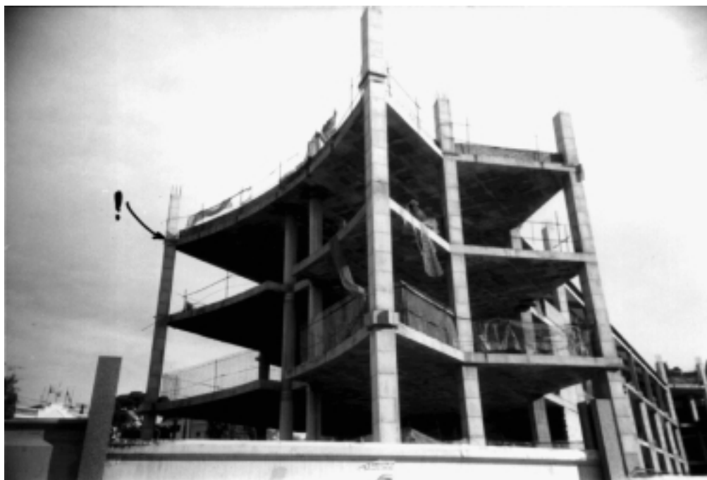
Foto 6.6 “Nudos” excesivamente débiles en el mismo edificio con columnas y forjados reticulares de la foto 6.5.
